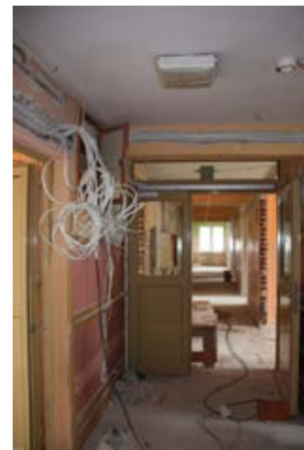
DPS przy ul. Łanowej 41 w Krakowie, budynek 41b - prace remontowo-instalacyjne na 2 piętrze budynku.
