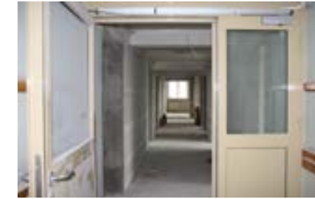
DPS przy ul. Łanowej 41 w Krakowie, budynek 41b - wykonano już większość prac wyburzeniowych i murarskich, a także wymieniono instalację elektryczną na nową.
